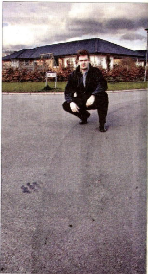
Formanden for grundejerforeningen Stagebjergparken i Almind, Jakob Johnsen, her på den asfalt, som i følge grundejerforeningen er både for tynd og for dårlig.
